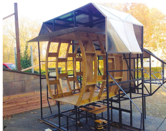
Obr. 3 Na stavbě modulu bylo odpracováno celkem 6 690 hodin, a to v rozmezí od 1. května 2018 do 17. června 2019. Foto: Archiv Planetum
