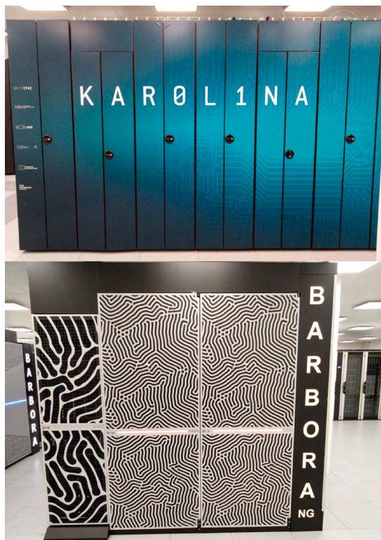
Obr. 4 Pro náročné vědecko-technické výpočty se využívají ty nejvýkonnější superpočítače, jako např. v superpočítačovém centru IT4Innovations na Vysoké škole báňské – Technické univerzitě Ostrava.
